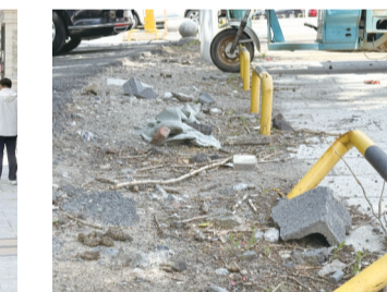
开运街与建工南路交会处阻车桩已锈断歪倒
