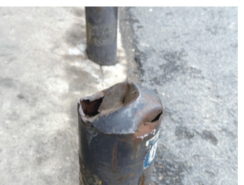
长春大街与清明街交会处金属桩破损
