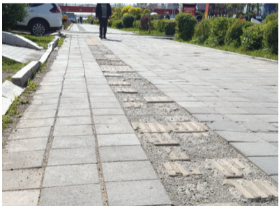
盲道破损严重
