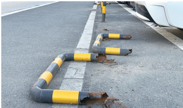
阻车桩破损倒伏 城市晚报全媒体记者 刘佳雪 摄
