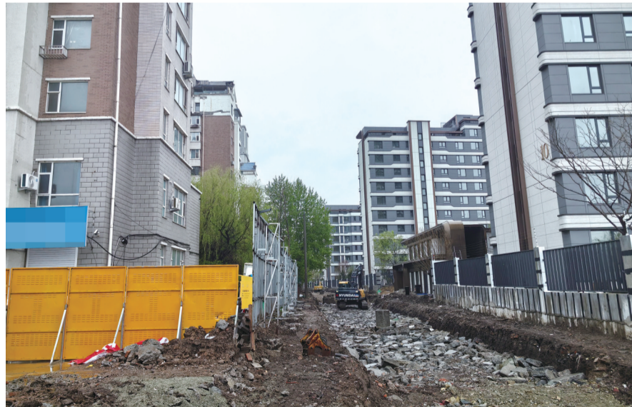
新建巷道工程正在有序推进 本组图片 城市晚报全媒体记者 陆续 摄
