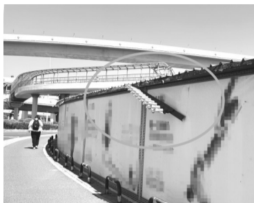
围挡装饰物破损下垂
