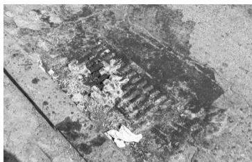
油污堵住雨水井
