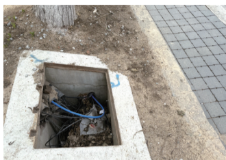
敞口的线缆井存在安全隐患
