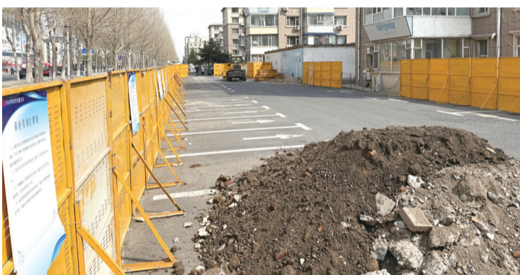
春城大街与锦西路交会处管线施工中 城市晚报全媒体记者 刘佳雪 摄
