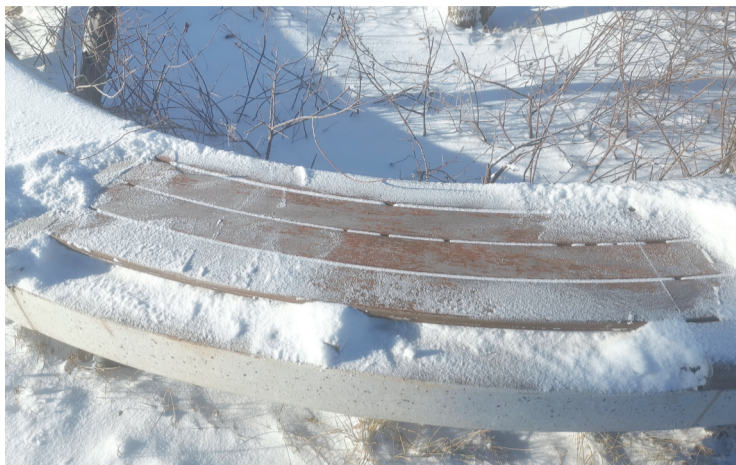
座椅损坏 本组图片 城市晚报全媒体记者 吕闯 摄
