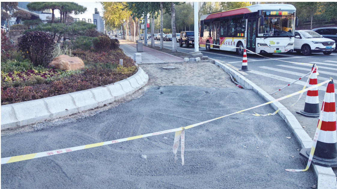
现场已经设置了路障 本组图片 城市晚报全媒体记者 陆续 摄
