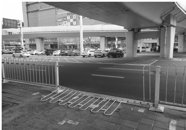
一段长约2米的护栏损坏倒地 本组图片 城市晚报全媒体记者 吕闯 摄
