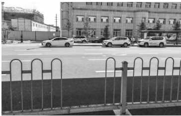
之前出现约半米宽的豁口
