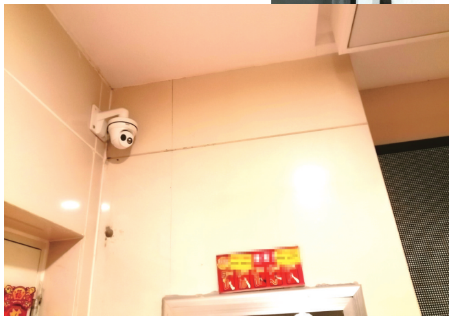
楼道内的摄像头
