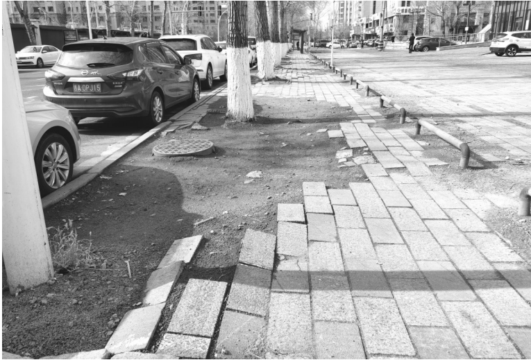
方砖缺失,沙土裸露在外 城市晚报全媒体记者 陆续 摄
