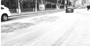
路面出现塌陷坑洼 本组图片 城市晚报全媒体记者 刘佳雪 摄
