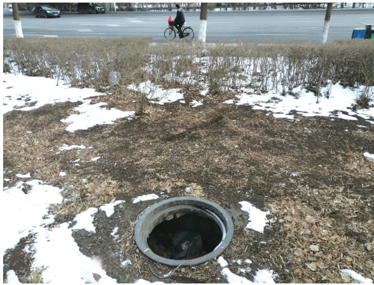
井盖丢失 本组图片 城市晚报全媒体记者 刘佳雪 摄
