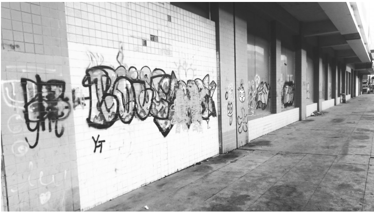
墙壁被各种涂鸦覆盖 本组图片 城市晚报全媒体记者 刘佳雪 摄
