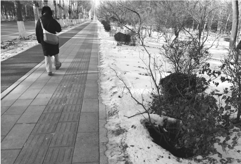
人行道旁的窨井盖不翼而飞 本组图片 城市晚报全媒体记者 刘佳雪 摄
