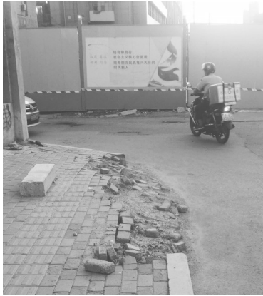
人行道出现严重破损 城市晚报全媒体记者 刘佳雪 摄
