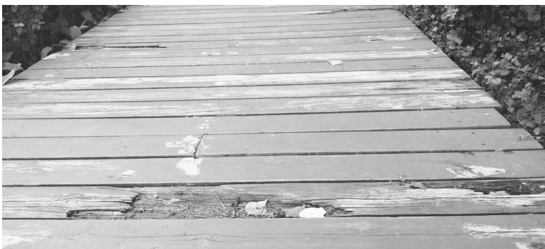
人行栈道破损严重 城市晚报全媒体记者 刘佳雪 摄
