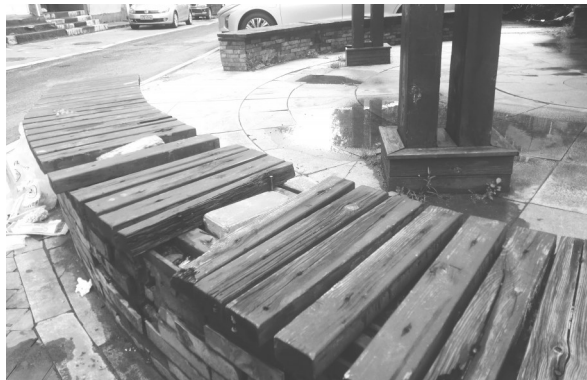
座椅破损亟待修缮 城市晚报全媒体记者 刘佳雪 摄
