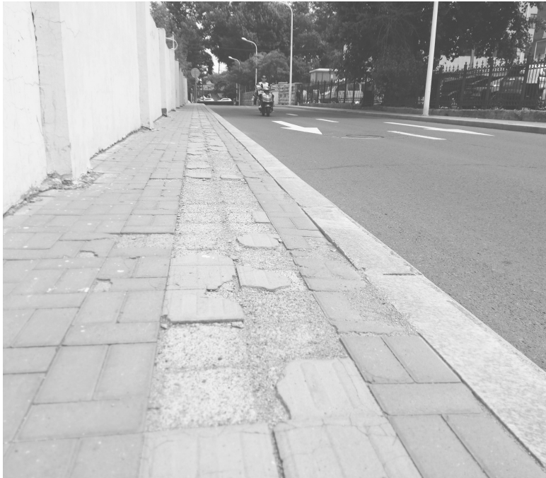
此处的人行道方砖破损 城市晚报全媒体记者 刘佳雪 摄
