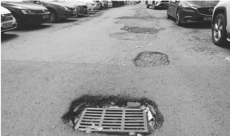
路面坑洼,附近居民出行不便 城市晚报全媒体记者 刘佳雪 摄 造成威胁。附近商户也表示,该路段可能因为车辆频繁进出碾压,加之最近持续降雨,导致坑洼越来越严重。 随后,记者将这一情况反映到长春市政务热线,工作人员表示,将联系属地单位现场查看,早日进行修复,确保市民及来往车辆的出行安全。 城市晚报全媒体记者 刘佳雪
