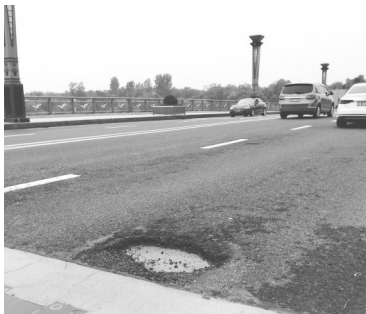
南湖大桥路面出现坑槽
