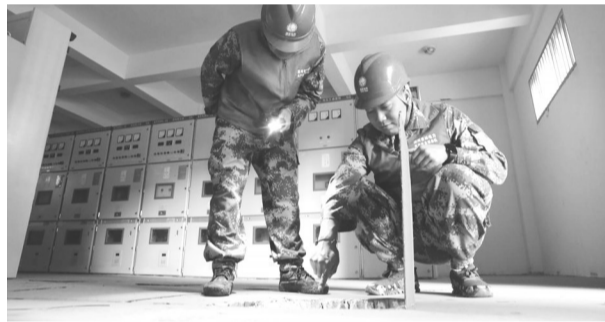
保障电网设备安全度汛 国网长春供电公司供图
