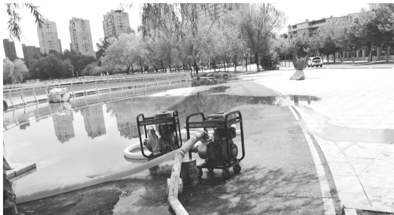
园林部门正在全力排水 城市晚报全媒体记者 刘佳雪 摄
