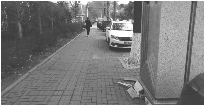
脱落的装饰砖碎片散落在地上 城市晚报全媒体记者 刘佳雪 摄
