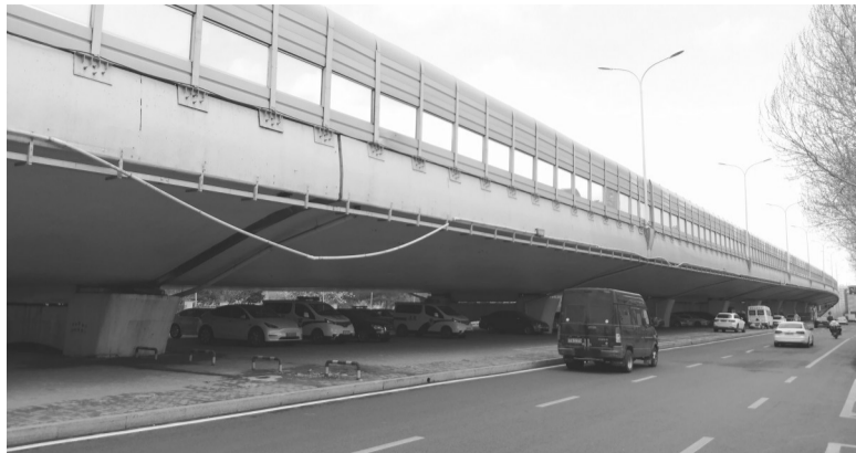
垂落的电缆线存在安全隐患 城市晚报全媒体记者 刘佳雪 摄
