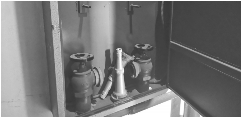
这里的消火栓没水没消防水带 城市晚报全媒体记者 刘佳雪 摄
