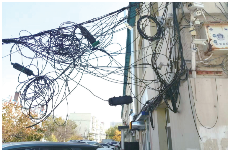
线缆宛如“蜘蛛网” 本组图片 城市晚报全媒体记者 刘佳雪 摄
