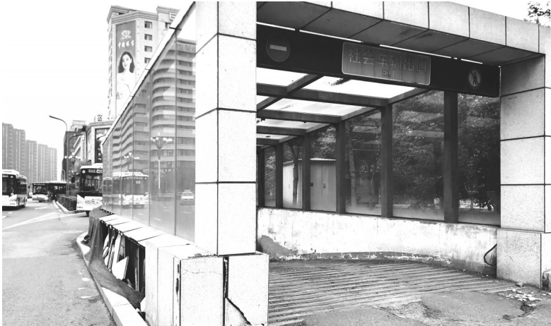
地下停车场出口破损严重 城市晚报全媒体记者 刘佳雪 摄
