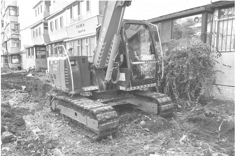
现场施工导致一些树木和绿植被破坏
