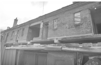
破败的新民胡同房屋
