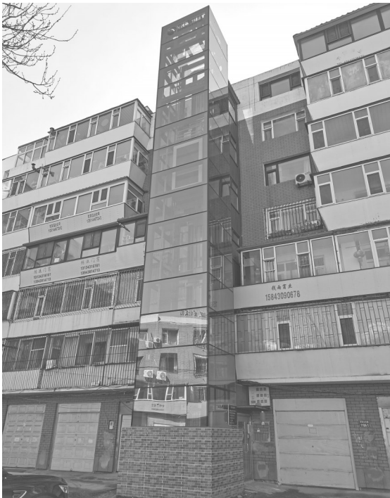
新华小区加装的电梯已经投入使用
