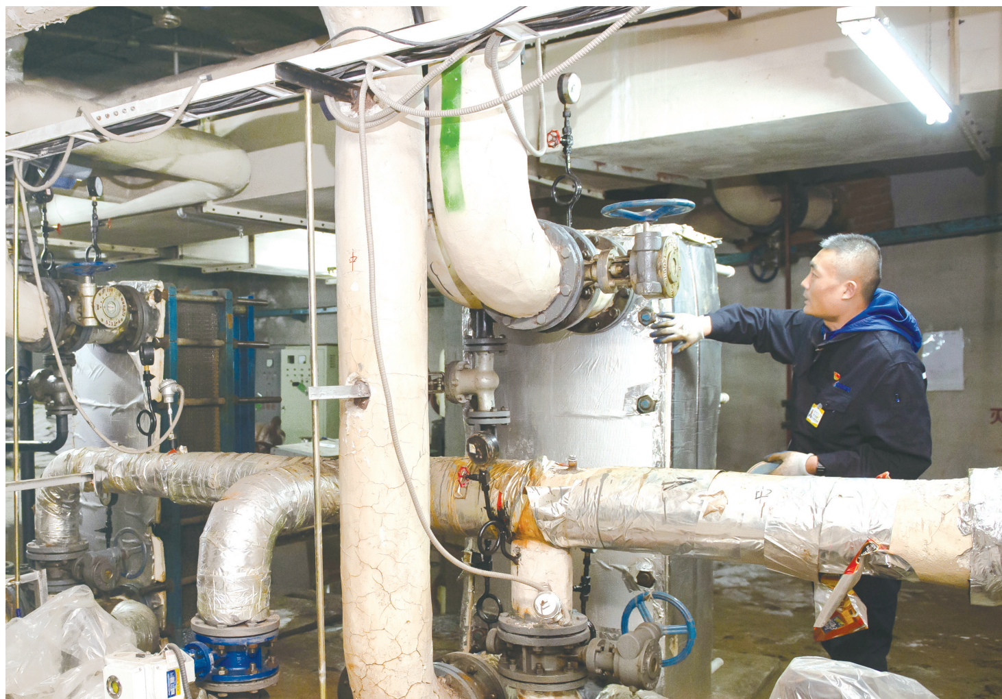
10月13日,长热集团中山换热站工作人员正在做供暖前检修 /城市晚报全媒体记者 蒋盛松 摄
